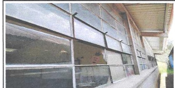
Foto 6: Se observan varios vidrios en mal estado en las ventanas de las aulas del módulo 4.
