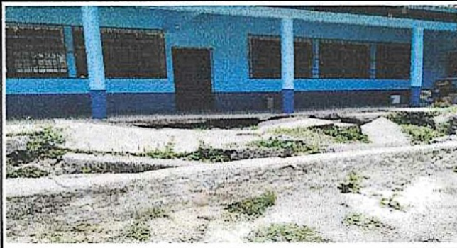
Foto 1: Requiere reparación de losa de patio. Módulo 1.
