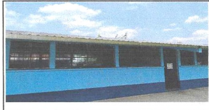
Foto 4: Se observa el deterioro en la estructura de los balcones y varios vidrios en mal estado en las ventanas de las aulas del modulo 3.
