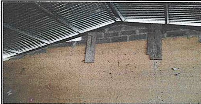
Foto 5: Se observa el deterioro de repellado y pintura en el modulo 3.
